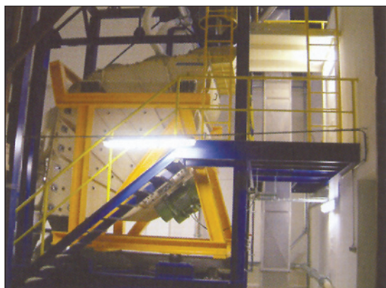
تصویر شماره ۱۲: نوسازی قسمت طباحی در Litovel
